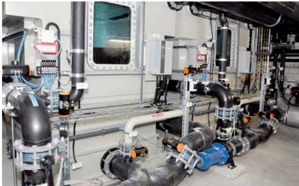
Viel aufwendige Haustechnik im Untergeschoss des 2016 erneuerten Hallenbads Uster: die Überlaufkammer mit Aktivkohlefiltern (rechts), die nachts durch Rückspülung gereinigt werden.
